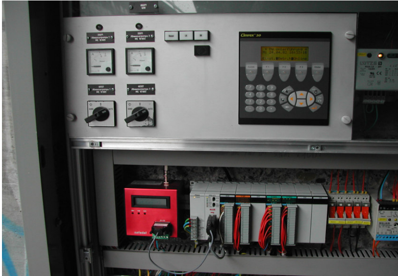
Abbildung 2: Schaltschrank mit SPS und SafeDat
